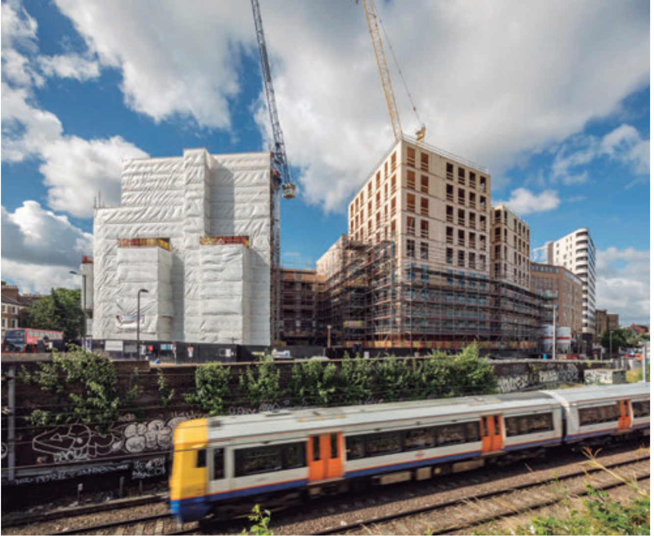
Proceso de construcción de las viviendas de madera de Dalston. (Fotografías de Daniel Shearing).
